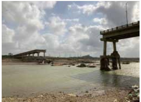
バローチスターン州とシンド州を繋ぐ橋が流され、交通もストップしている状況
