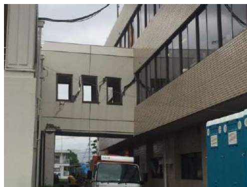
地震で大きな被害を受けた益城町役場
