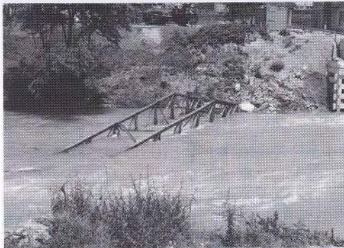
洪水の影響で、橋が崩落した様子 復旧のめどはたっていないという
