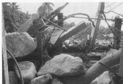
土砂で埋もれた建物の様子
