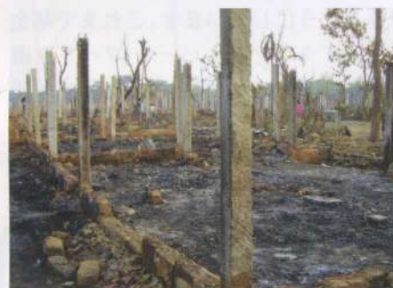
焼け落ちた住居。鉄筋コンクリートの柱だけが焼け残り、屋根と壁は全て焼失
