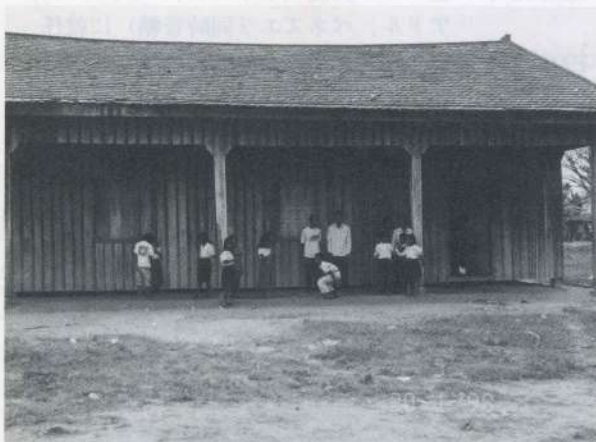
チャンバック小学校（屋根が曲がっています）
