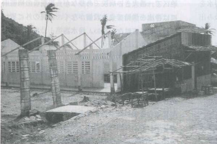
全壊した村の学校の屋根はない
