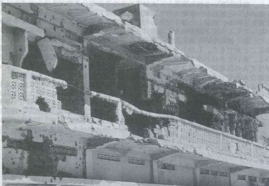
砲撃を受けて崩れた民家
