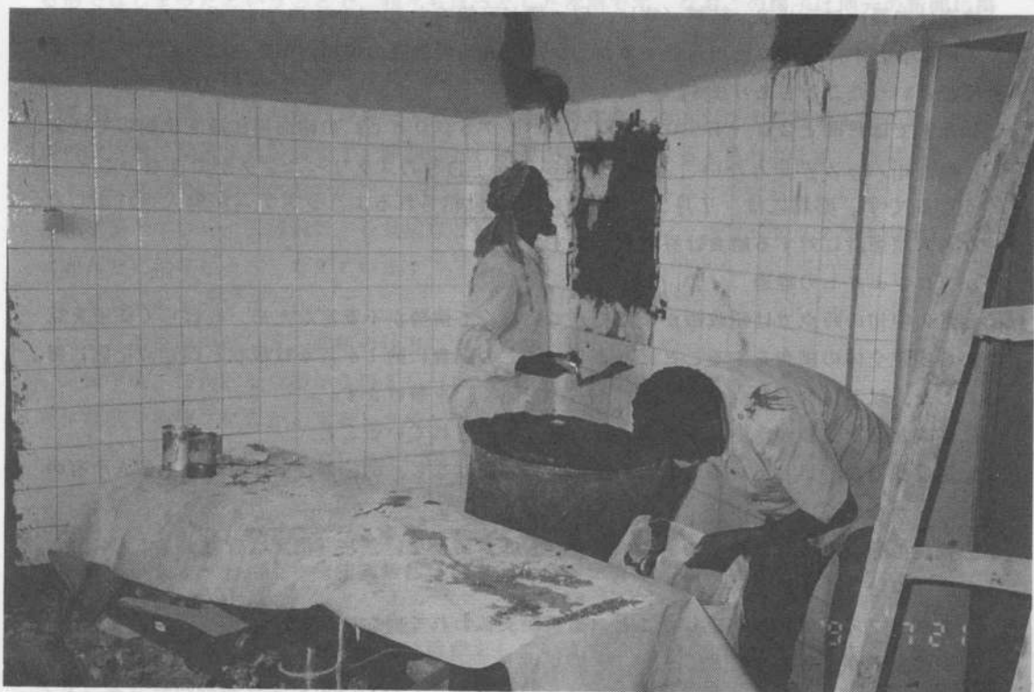
ハルゲイサ中央病院 UNHCRとのプロジェクト 内戦で破壊された壁を修復中
