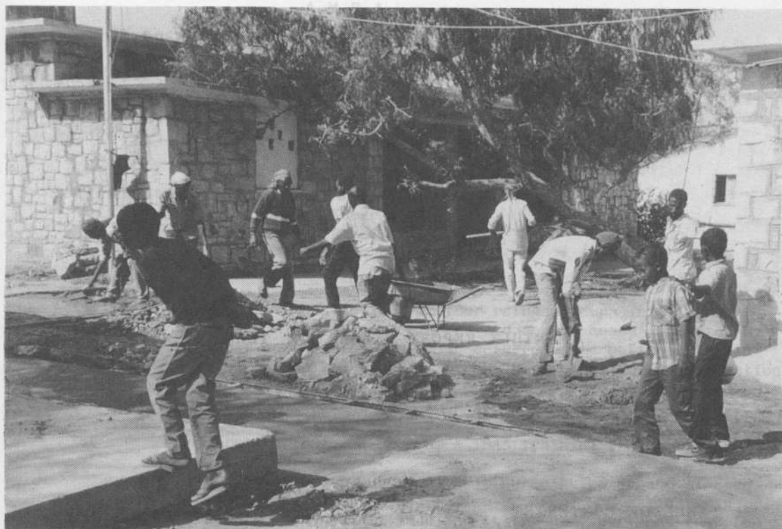
ハルゲイサ中央病院 再建工事に熱心に従事する労働者たち
