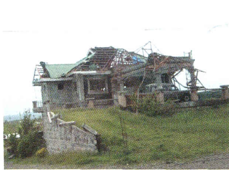
▲ 屋根の被害が甚大。風の威力がすさまじい。
