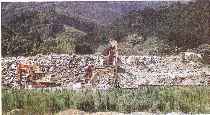
被災地の至る所に点在するがれきの山。作業中の重機が小さく見えるほど。うずたかく積まれている。8月27日、岩手県大槌町
