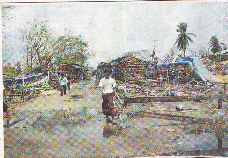
屋根や壁が吹き飛ばされた家が多くあるヤンゴン市内
