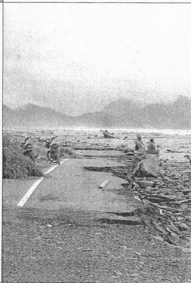
津波被害1年経ても道路が寸断されたまま。復興の道のりは険しい。昨年11月、インドネシア・バンダアチエ(斎藤章一朗撮影)
